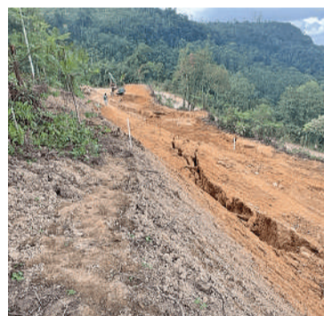
FISURAS motivaram interdição
