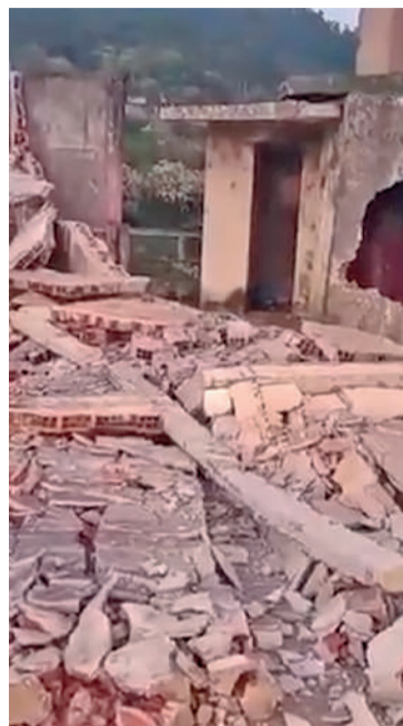
MURO e casa de ferramentas, foram destruídas
