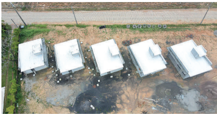
CINCO casas da Defesa Civil de SC estão sendo edificadas no complexo
