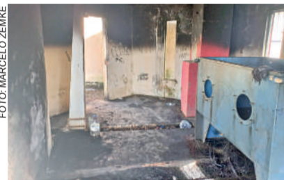
CASA de máquinas está danificada
